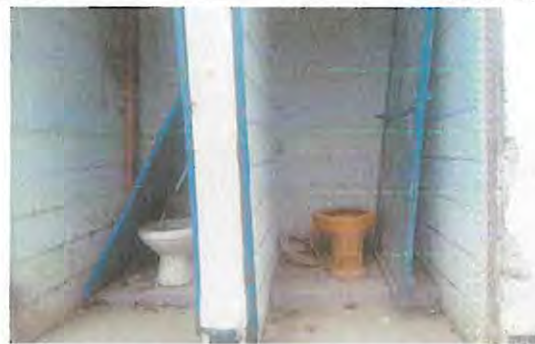
Foto 6: De esta forma estan los sanitarios en la actualidad.
