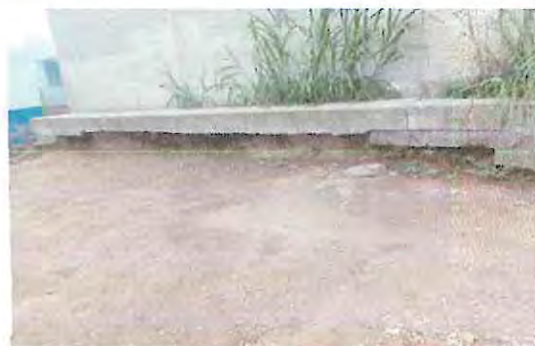
Foto 2: Así estan las banquetas actualmente
