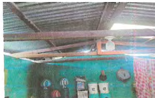
Foto 4: así está la madera de la cocina actualmente
