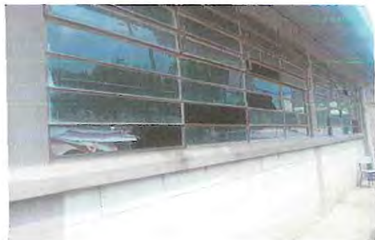
Foto 1: Estos son parte de los vidrios quebrados, actualmente
